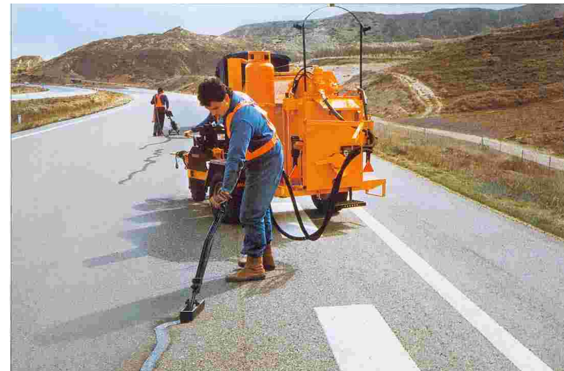
Pontages de fissures : 4€ /ml (entreprise)
